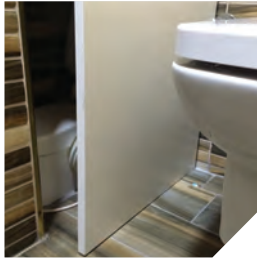
Lavabo altına gizlenmiş SANIFLO
