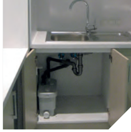
Mutfak dolabına yerleştirilmiş SANISPEED
