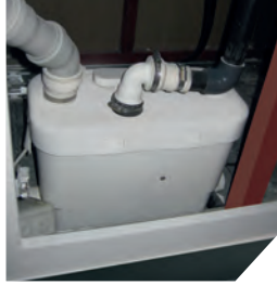
Alçıpan içine gizlenmiş SANISPEED pompa
