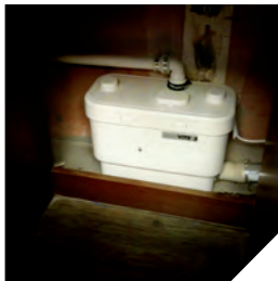
Tezgahın altına gizlenmiş SANIVITE pompa
