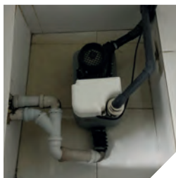
-1. kattaki depoya kurulmuş SANICOM 1
